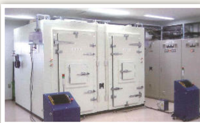
流通鮮度保持室 (フードバレーアグリビジネスセンター)
