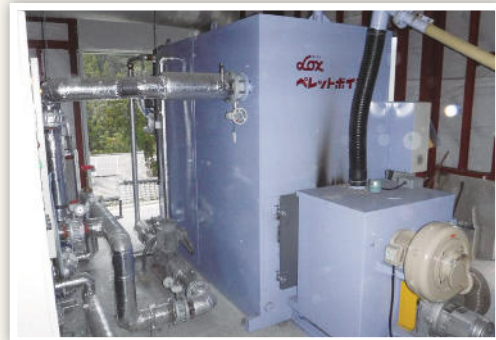
木質バイオマスボイラー (坂本温泉センタークレオン)
