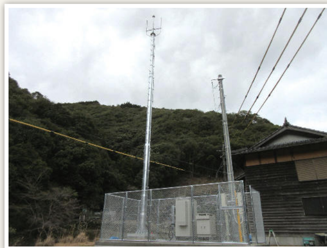
携帯電話基地局（坂本町袈裟堂）
