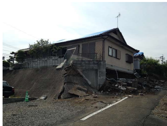
図 1.2.5 盛土擁壁の被害
