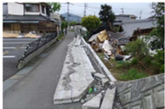
図 4.5.5 ブロック塀の倒壊(熊本大学減殺型社会システム実践研究センター)
