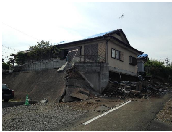
図 1.2.5 盛土擁壁の被害
