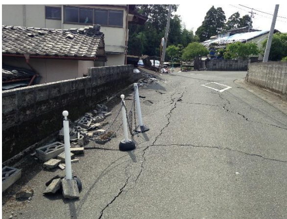
図 1.2.4 建築物外周部の地盤の変状
