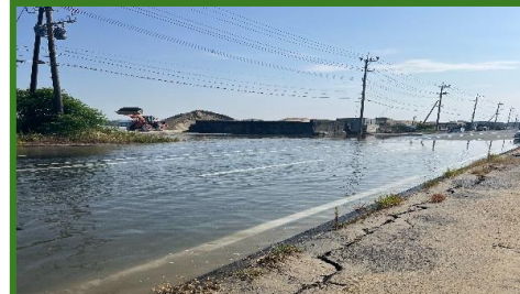
沿岸部では地盤が沈下し、8月 の大潮では八代港で浸水が発生
