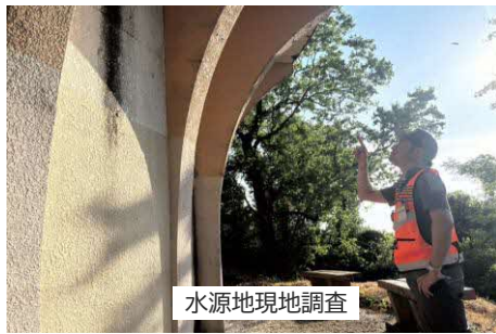
水源地被災状況
