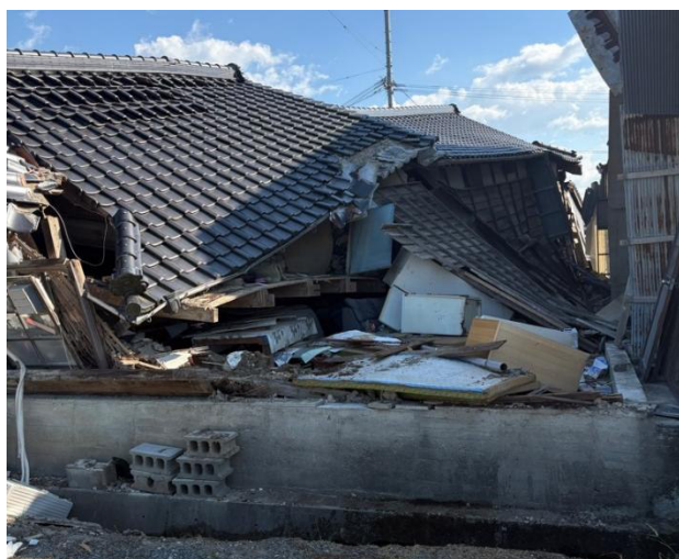
織機小屋の倒壊
