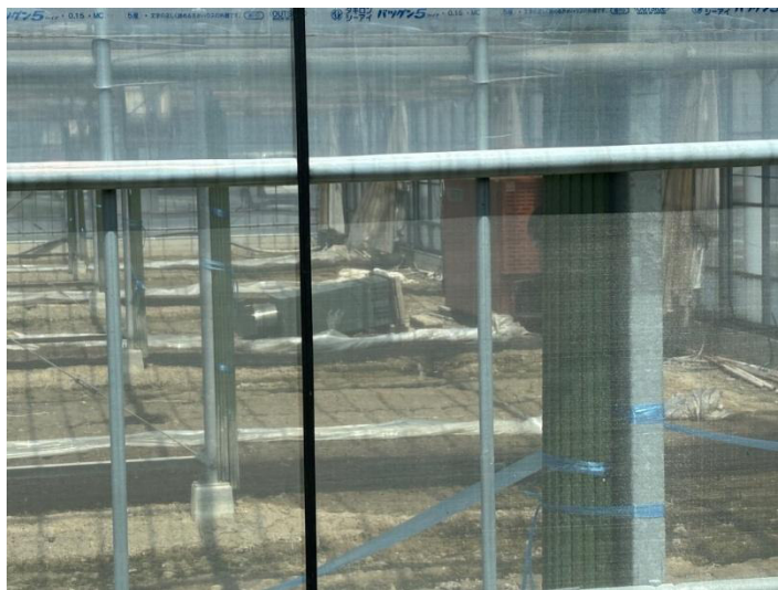
液状化によるハウスの損壊
