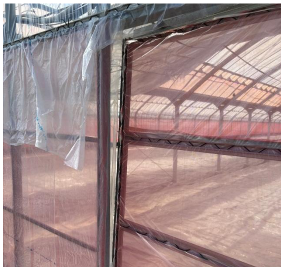
地盤沈下によるハウスの歪み
