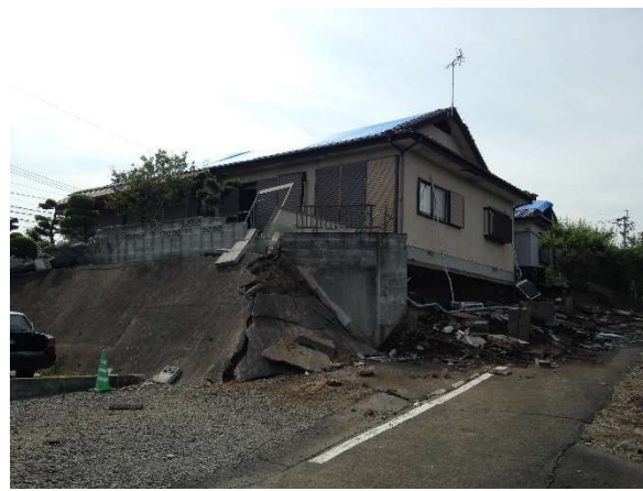
図 1.2.5 盛土擁壁の被害
