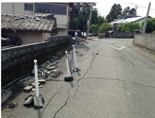
図 1.2.4 建築物外周部の地盤の変状
