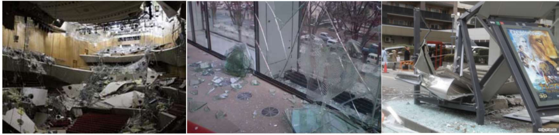
図 4.5.1 非構造部材の被害【天井・窓ガラス・外壁】 (写真：(左) 国土交通省、(中、右) 仙台市)
