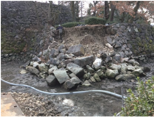
Photo.15 熊本地震で倒壊した八代城跡の石垣
