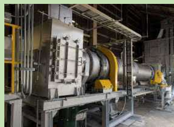
粉穀を用いたバイオ炭製造施設
