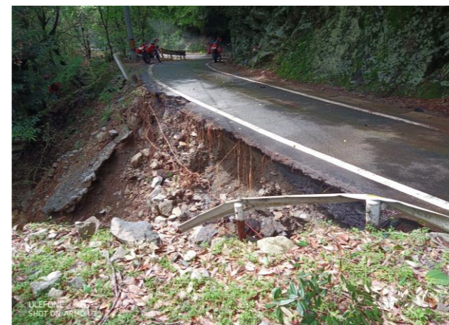
▲県道247号(久連子地区)の道路崩落現場 令和2年7月12日撮影
