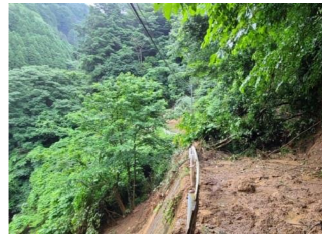
▲国道445号(椎原地区)の崩土現場 令和2年7月11日撮影
