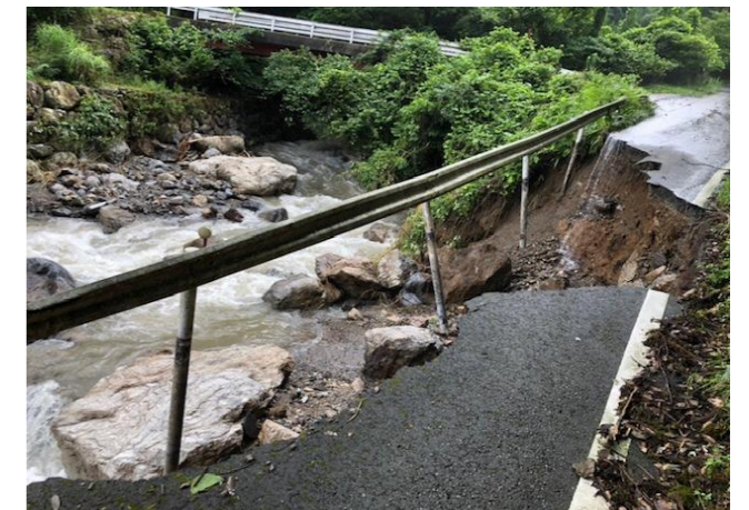
▲県道247号(古園地区付近)の道路崩落現場 令和2年7月12日撮影
