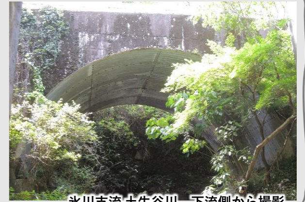
氷川支流 土生谷川 下流側から撮影
