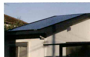
▲設置された太陽光パネル
