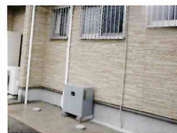
▲設置された蓄電池
