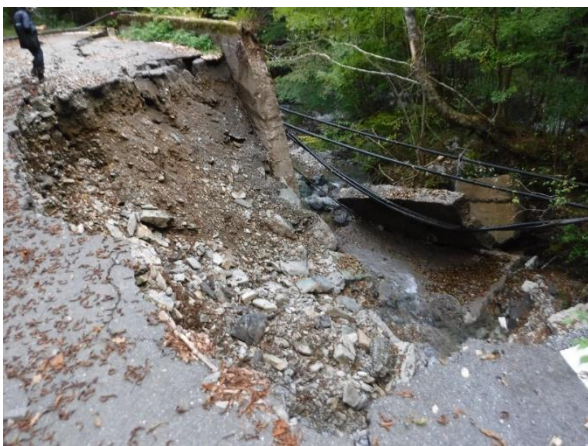
令和4年台風14号の被害状況 (八代市泉町五家荘～椎葉線：被災箇所④)
