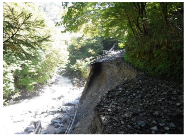
令和4年台風14号の被害状況 (八代市泉町五家荘～椎葉線：被災箇所③)
