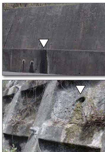
地下水の流出
