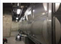
耐震性貯水槽
