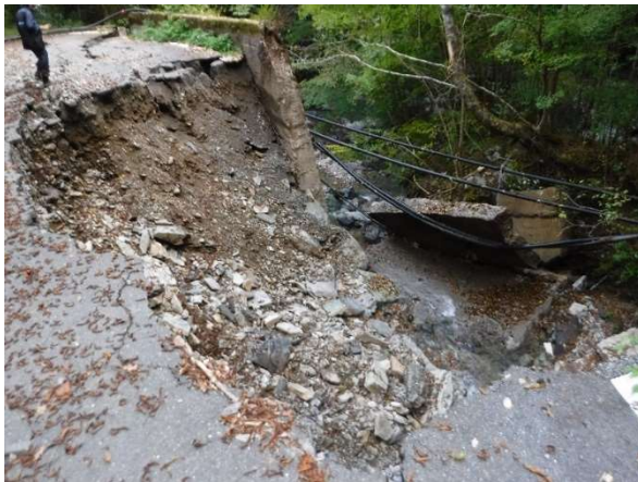
令和4年台風第14号の被災状況 (八代市泉町五家荘～椎葉線：被災箇所④)
