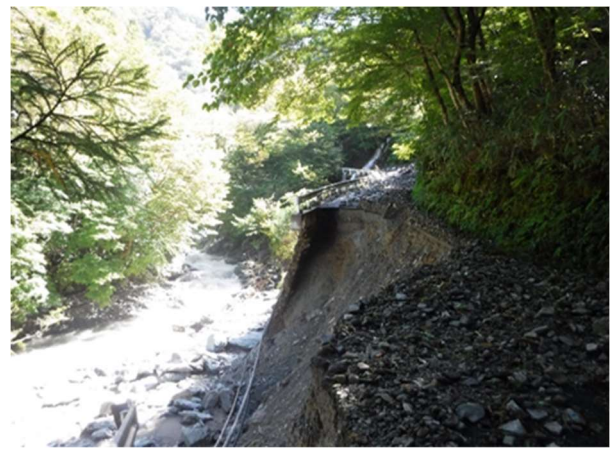
令和4年台風第14号の被災状況 (八代市泉町五家荘～椎葉線：被災箇所③)
