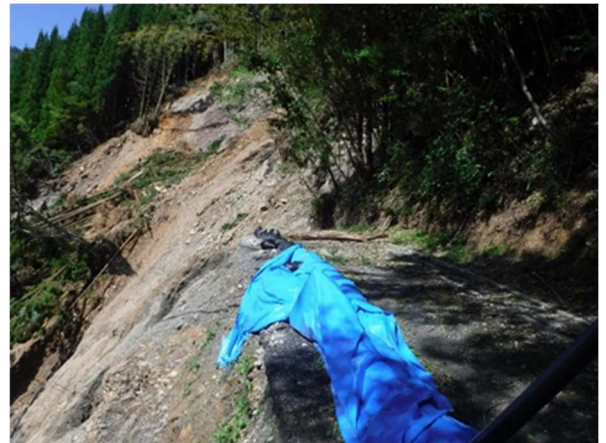
令和4年台風第14号の被災状況 (八代市泉町八八重～四方田線：被災箇所①)
