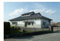
⑦ 松崎中継ポンプ場
