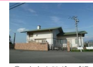
⑨ 麦島中継ポンプ場
