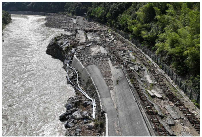
令和4年台風第14号の被害状況 (八代市坂本町)
