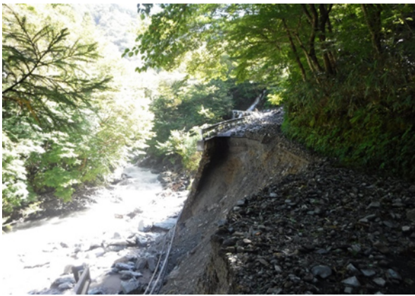
令和4年台風第14号の被害状況 (八代市泉町)
