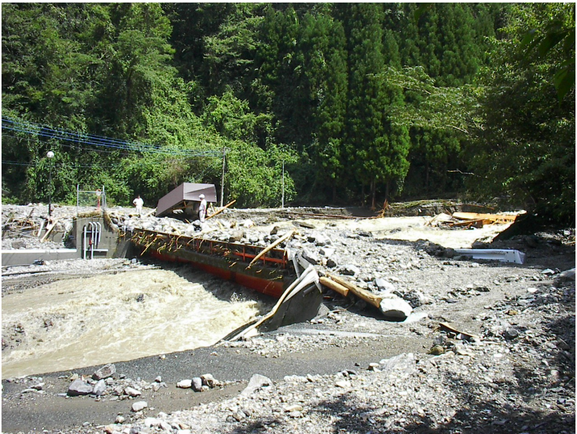
泉町 山ノ津谷川(平成17年 台風14号被災)
