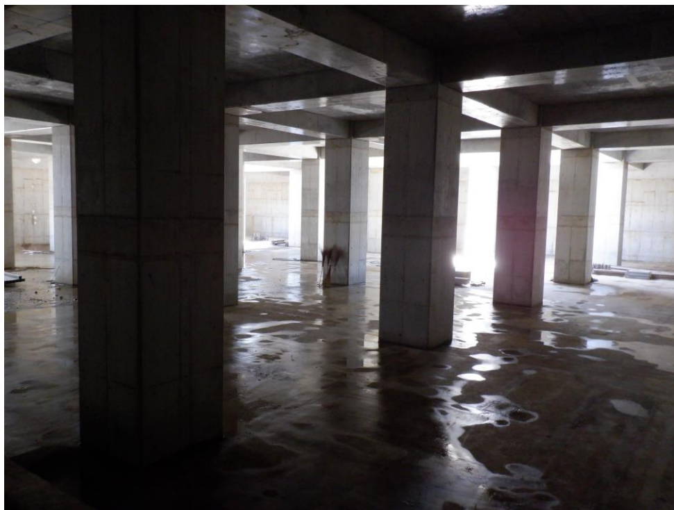
「防災・減災、国土強靱化のための3か年緊急対策」で実施した 北部中央雨水調整池整備工事の状況
