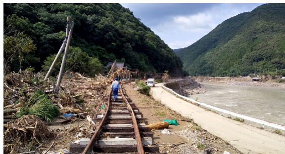
▲土石流等の被害(JR 肥薩線 吉尾地区)
