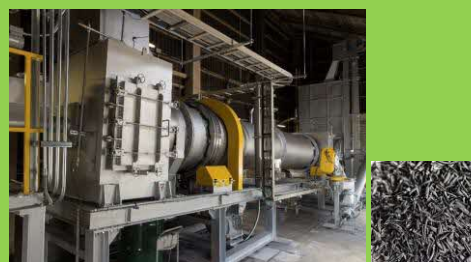
籾殻を用いたバイオ炭製造施設
