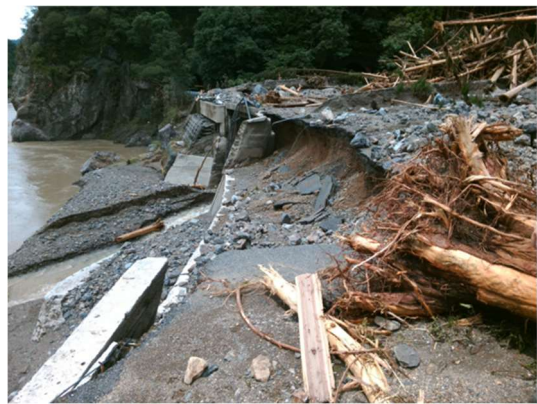
[写真] 県道158号線土砂流出・路面崩壊
