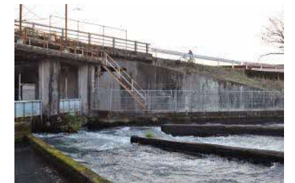
球磨川から水を引き入れる用水路の入口
