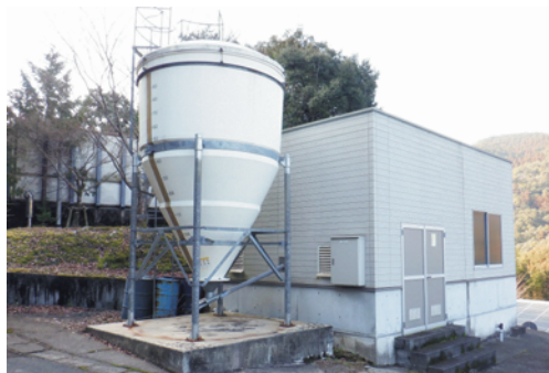
さかもと温泉センター（木質バイオマスボイラー）
