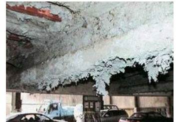
劣化した吹付けアスベスト
