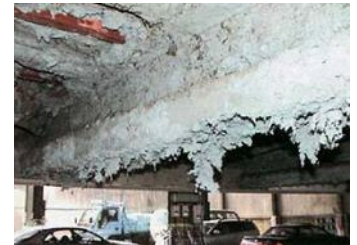
劣化した吹付けアスベスト
