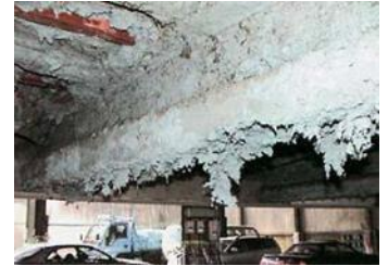
劣化した吹付けアスベスト
