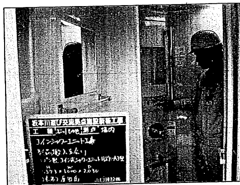
写-3 ユニットシャワー
