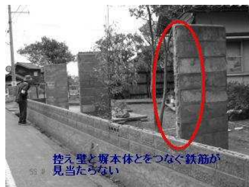
写真9 地震で塀本体が倒壊した施工不良の被害例
