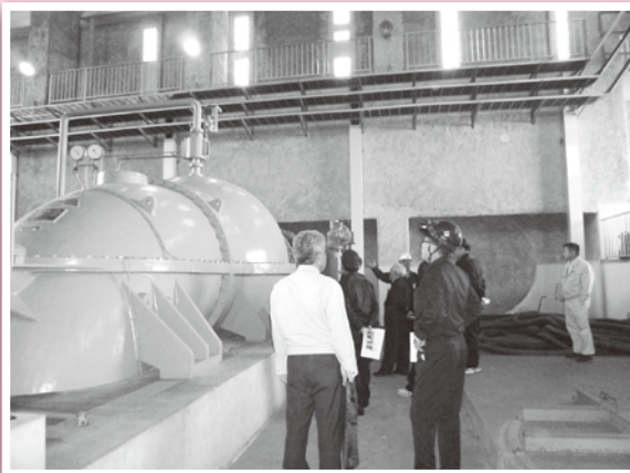
▲ 下水道の中央ポンプ場内
