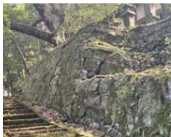
崩落しそうになっている石垣（松井家墓所内）
