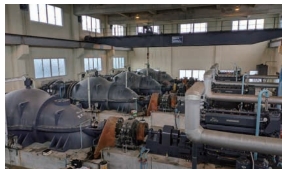
八代南部排水機場内のポンプ
