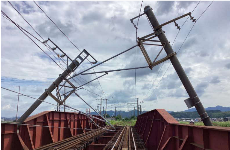
小川・有佐間(橋りょう上電柱損傷)
