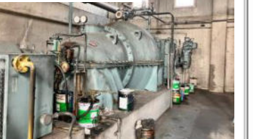
6.昭和第二排水機場
