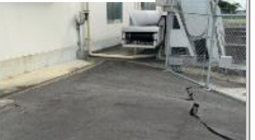
5.八代中央排水機場
