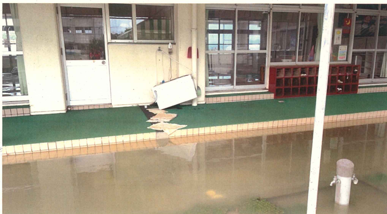
千丁幼稚園 被害状況(床上浸水)
