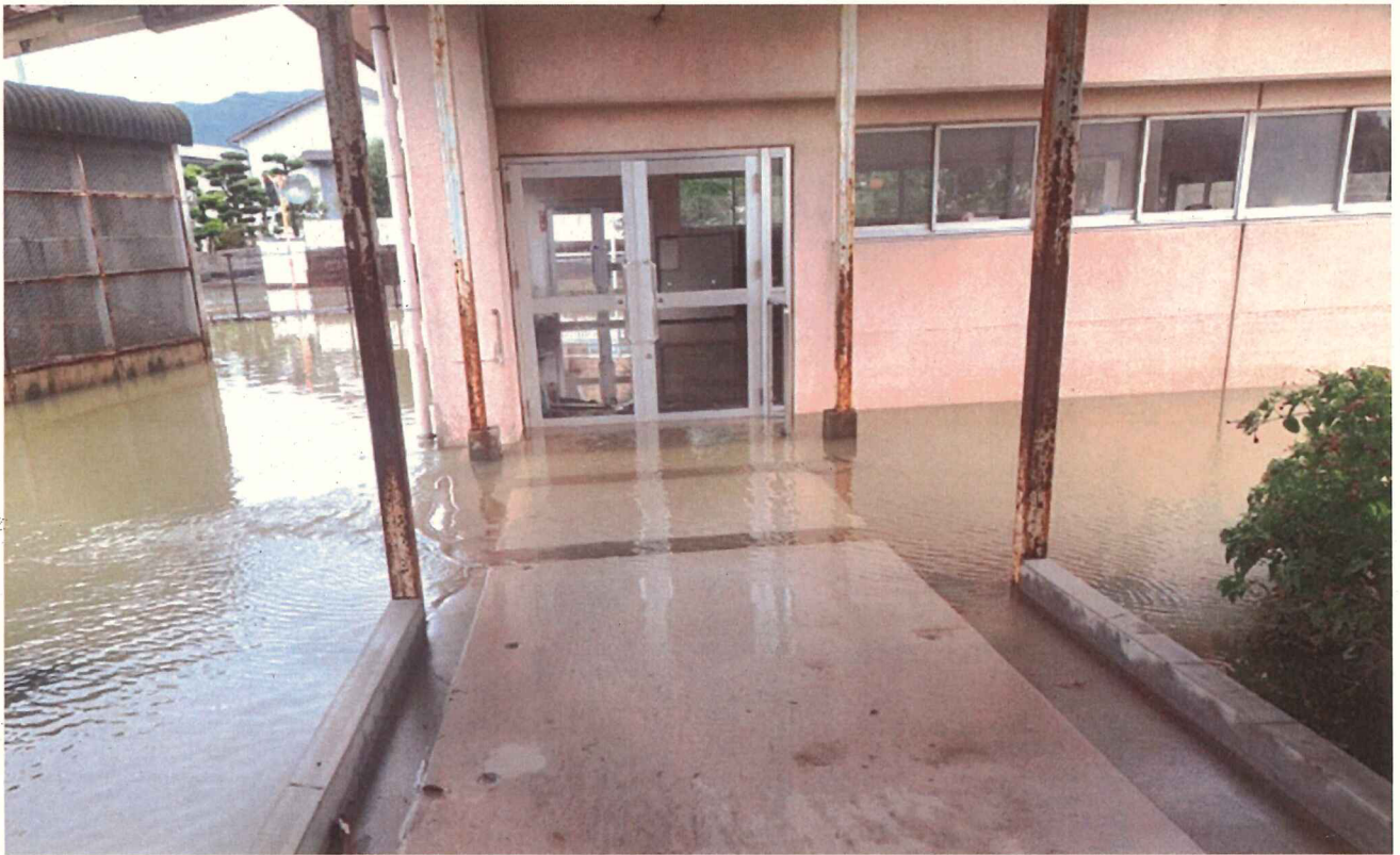
千丁小学校 被害状況(床上浸水)
