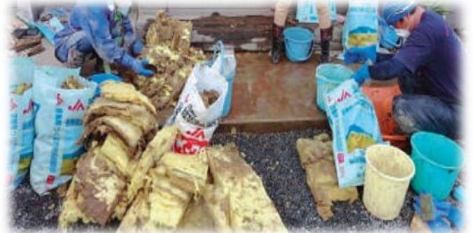
浸水したグラスウール
