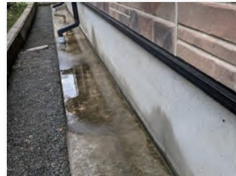
雨が降っていないのに水がにじみ出ている
