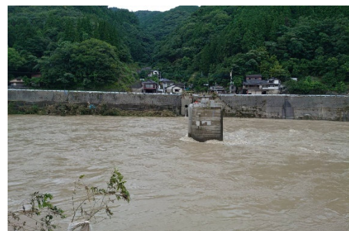
（流出した坂本橋の橋脚）
