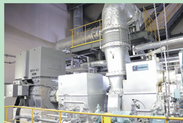
蒸気タービン発電機
