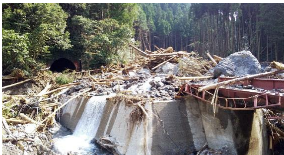
▲土石流等の被害(JR 肥薩線 行徳川橋梁)
