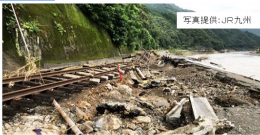
▲路盤が流出した肥薩線の葉木～鎌瀬間。奥が人吉方面
