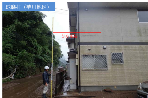
過去に宅地かさ上げした家屋が4m程度浸水 出典: 国土交通省九州地方整備局八代河川国道事務所HP
