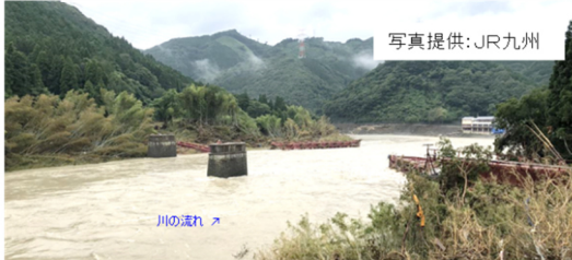
▲那良口駅～渡駅間 第二球磨川橋梁 (L=179m) 流失
