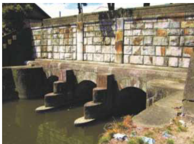
11. 郡築二番町樋門(斜めより撮影)
