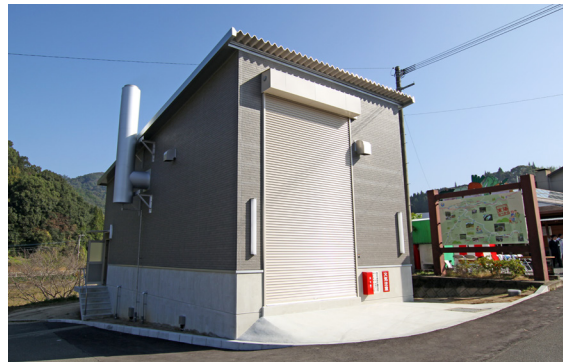
▲地下サイロに木質チップを貯蔵する木質バイオマスボイラー
