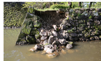
▲八代城址の石垣も崩落
